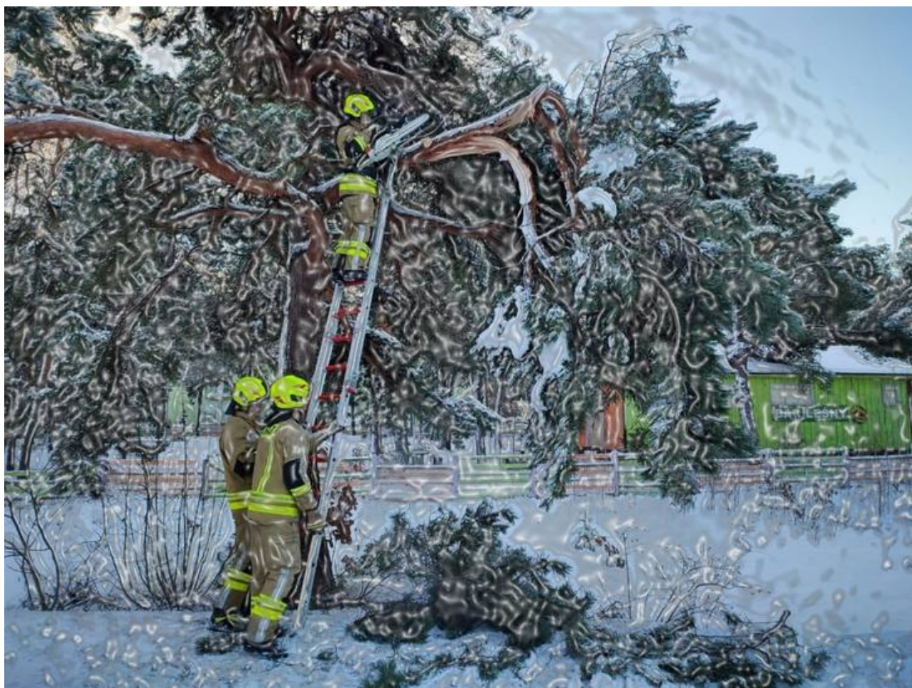
Powalone drzewo na linie energetyczne.
